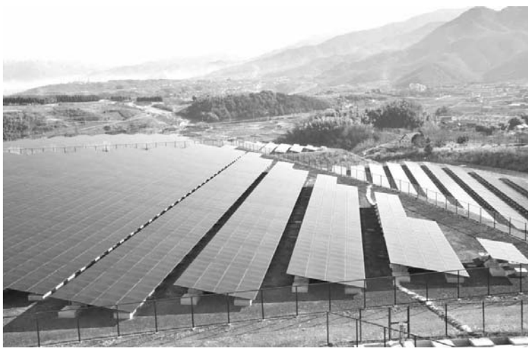
甲府市の丘陵地に設置された米倉山太陽光発電所の太陽電池パネル
