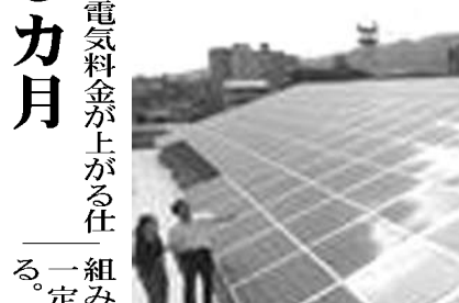
最大出力50キロワットを超える太陽光発電パネルが設置されている神戸市・御影中学校
