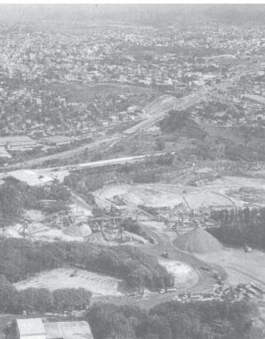
エスピリト・サント州ヴィトリア周囲の道路工事もPACC適用後に見直された
