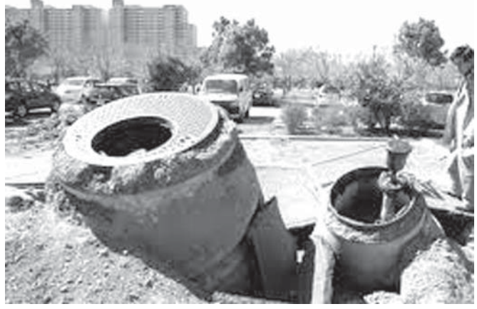
液状化で浮き上がったマンホール＝千葉県浦安市
