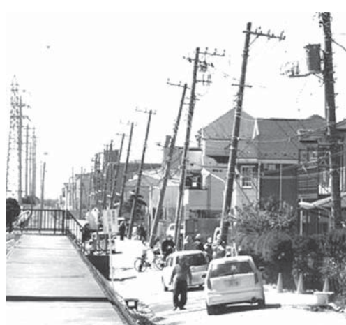
地震による液状化で被害を受けた千葉県浦安市の住宅
