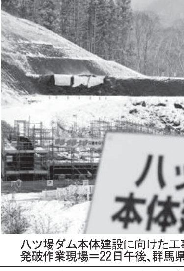
ハツ場ダム本体建設に向けた工事が始まり、白煙が上がる発破作業現場=22日午後、群馬県長野原町
