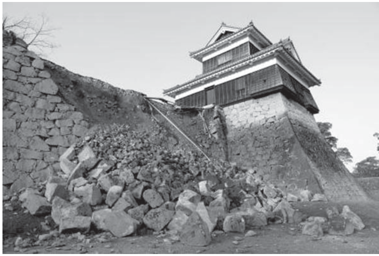
地震で崩れた熊本城の石垣=15日午前6時47分、熊本市中央区
