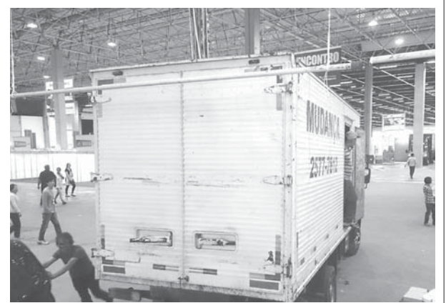
ガス管の外れた箇所(写真上部)。郷土食広場と企業ブースの中間にあり、ちょうど会場中央から大量のガス漏れが発生した
