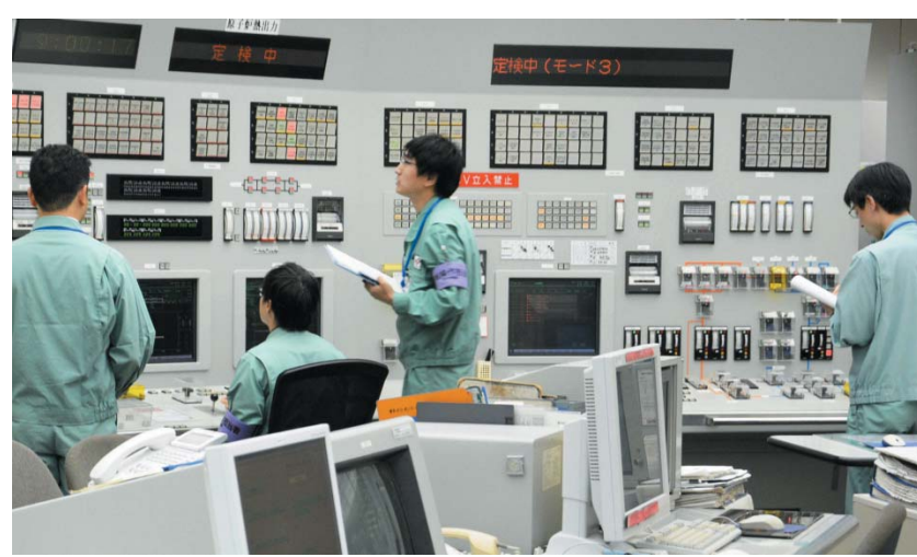
伊方原発3号機の中央制御室で、再稼働のための操作をする四国電力の社員＝12日午前9時ごろ、愛媛県伊方町（代表撮影）
