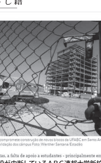
建設が中断しているABC連邦大学新校舎（15日付エスタード紙の記事の一部）
